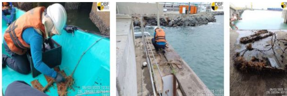
Fig. 3. Placas recolhidas do PI2 (Cais 04), placas substituídas do PE1 (CMU) e PE3 (PGL3B). Foto: DBF Planejamento e Consultoria.
